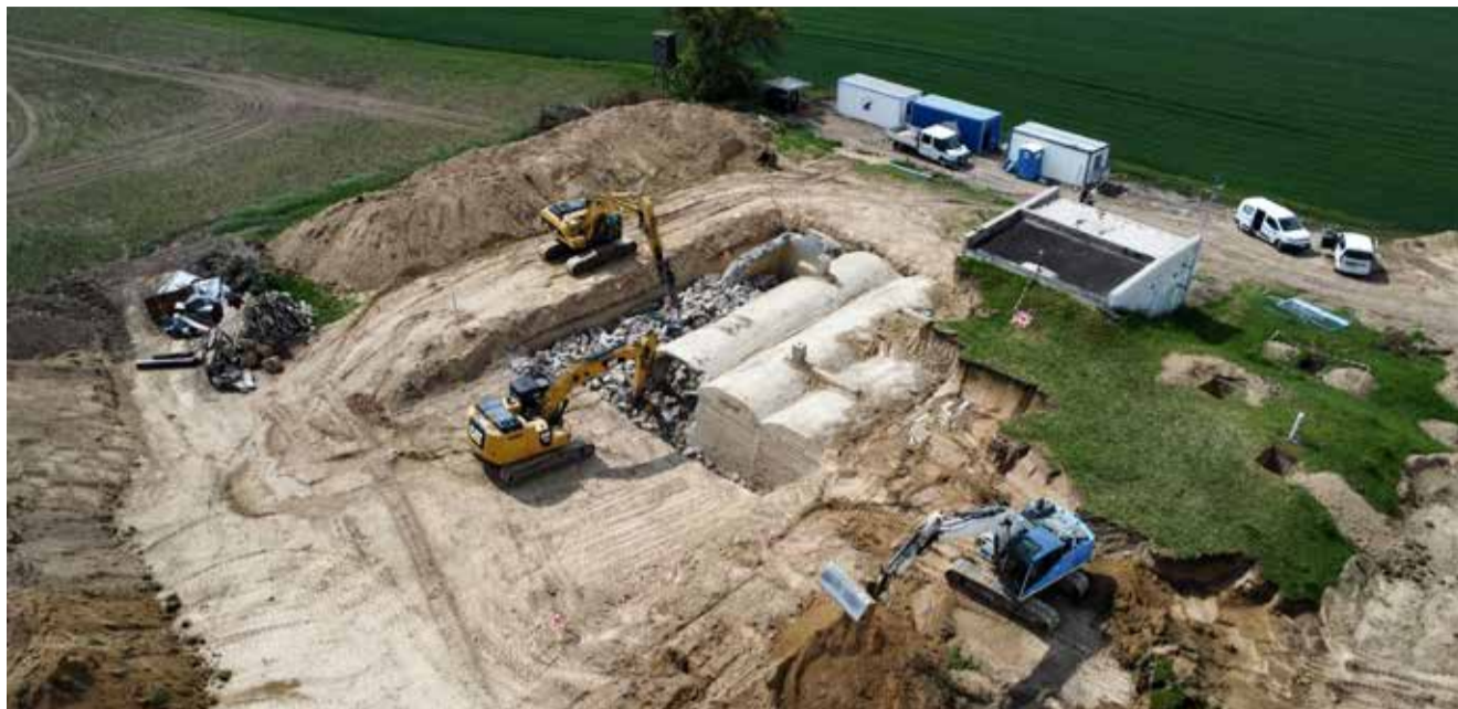
Hlavním důvodem rekonstrukce vodojemu je jednak jeho stáří, a jednak netěsnost původních komor
