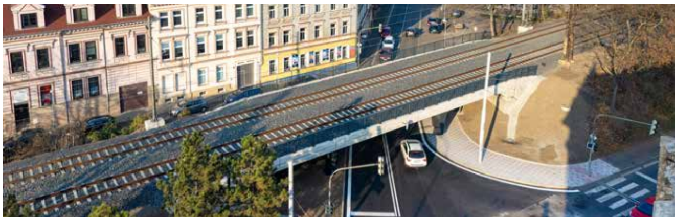
Nový most se dvěma středovými ocelovými pilíři založenými na pilotách je oproti původnímu mostu širší
