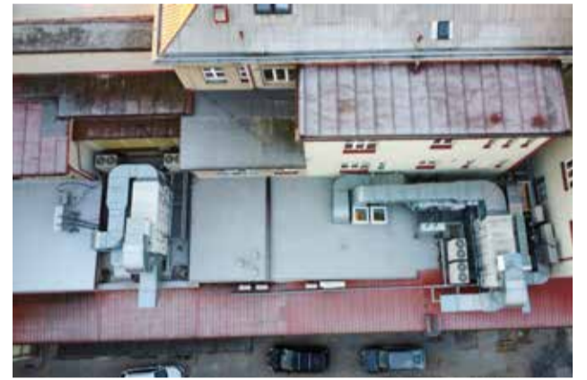
Na střeších vestavb jsou umístěny nové technologie
