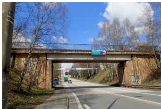
Most byl před rekonstrukcí ve špatném stavu
