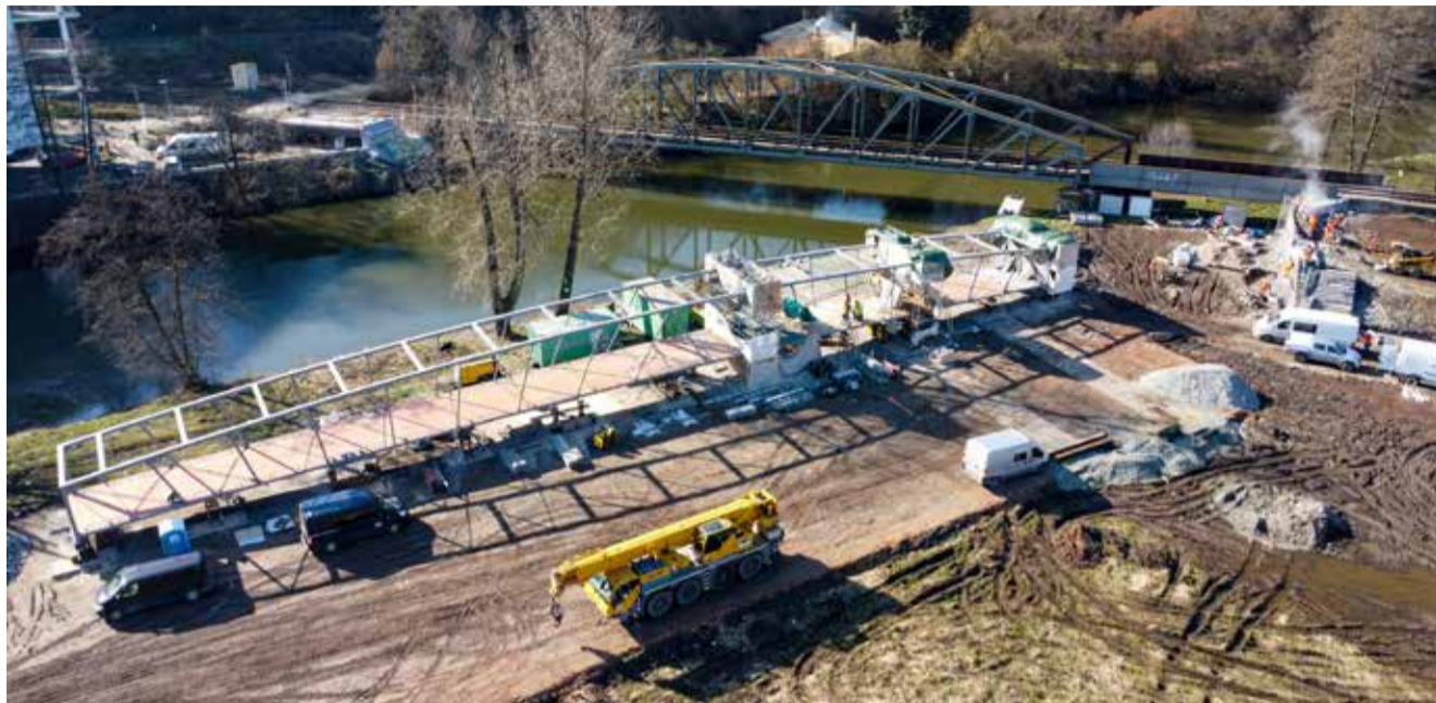
Mostní pole délky téměř sedmdesát metrů je již připravené k usazení na opěru a pilíř
