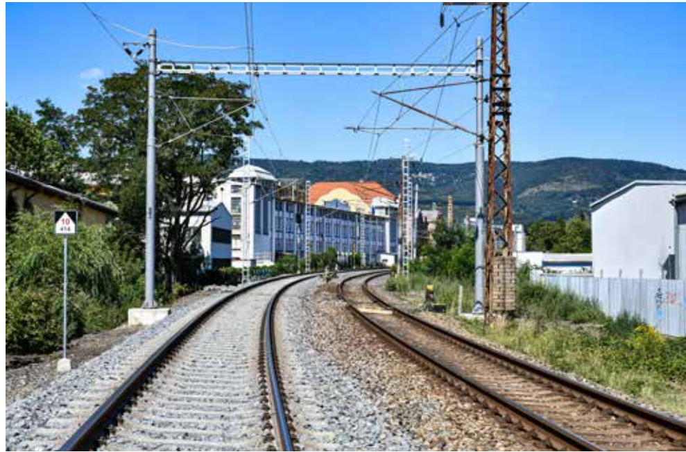
ČTYŘI MĚSÍCE. Rekonstrukce 2. traťové koleje na přibližně čtyřkilometrovém úseku byla provedena včas.
