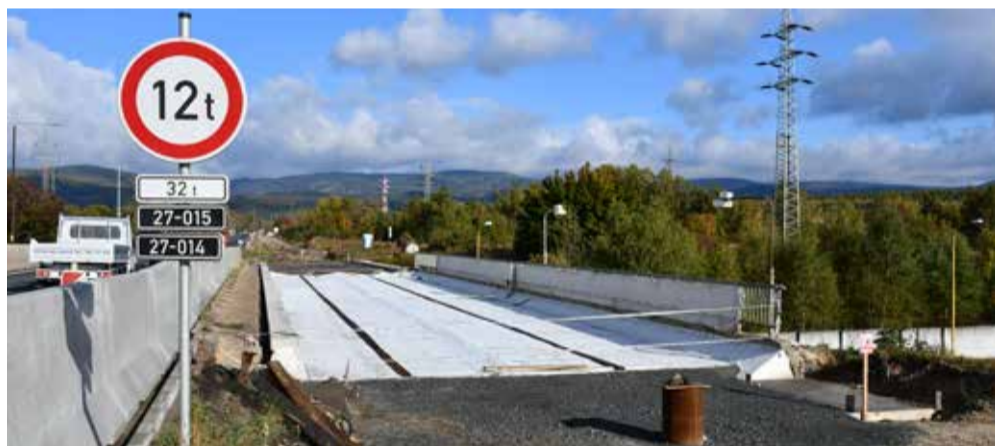
TRAMVAJOVÉ SOUMOSTÍ. Stav předpjatých betonových konstrukcí je mnohem horší, než se čekalo.
