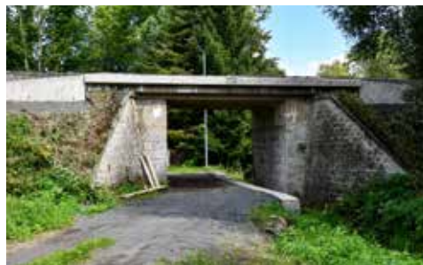
Most v obci Horní Podluží má navýšené římsy
