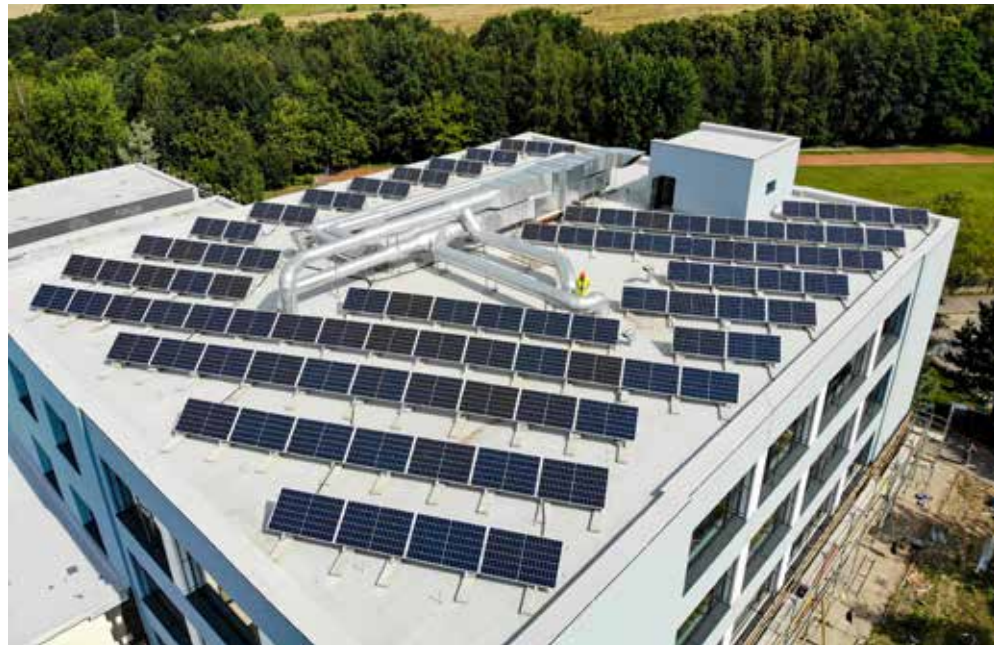
ÚSPORA AŽ 40 %. Ke snížení spotřeby energií přispějí fotovoltaické panely na střeše učebního objektu A
