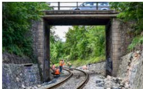
Zed' se na mnoha místech rozpadá
