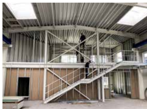
Kromě výrobního prostoru je součástí haly technické zázemí se sklady, toaletami a konferenční místností
