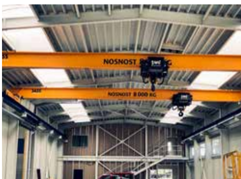
Montovaná hala s výrobní plochou 700 m 2 je vybavena dvěma portálovými jeřáby o nosnosti 16 tun
