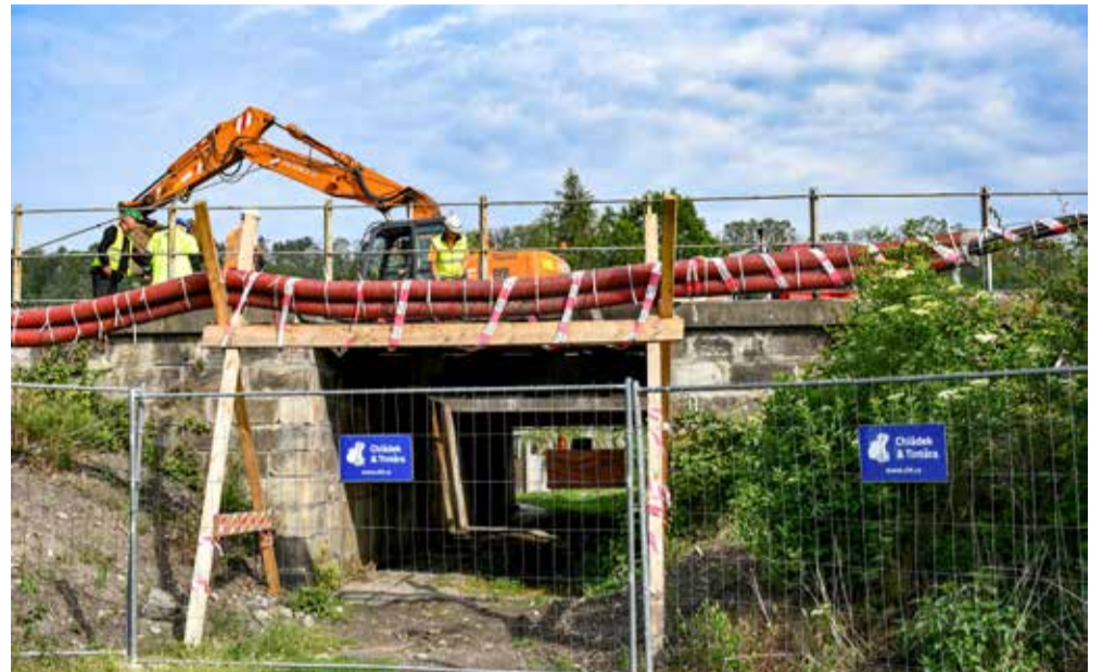
KRATŠÍ A VYŠŠÍ. Světlá výška nového mostu umožní zejména průjezd menších vozidel městské údržby
