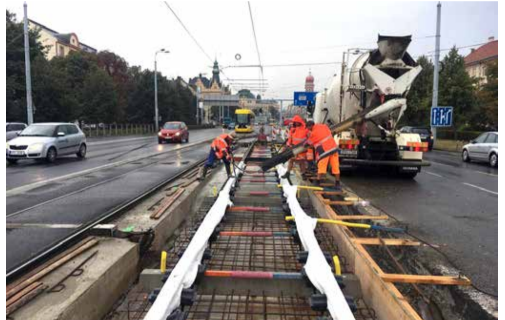
W-TRAM. Buduje se odshora dolů, tedy nejprve se umístí kolejový rošt a teprve poté se koleje podbetonují.
