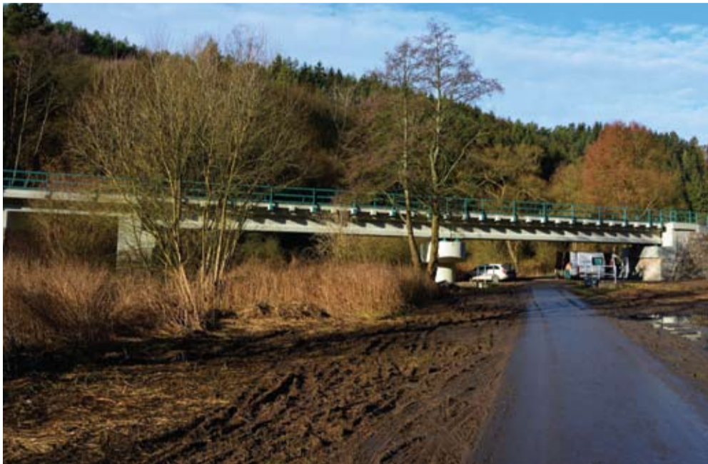
DVAKRÁT 50 m. Dva shodně dlouhé mosty na trase byly časově nejnáročnějšími objekty celé stavby
