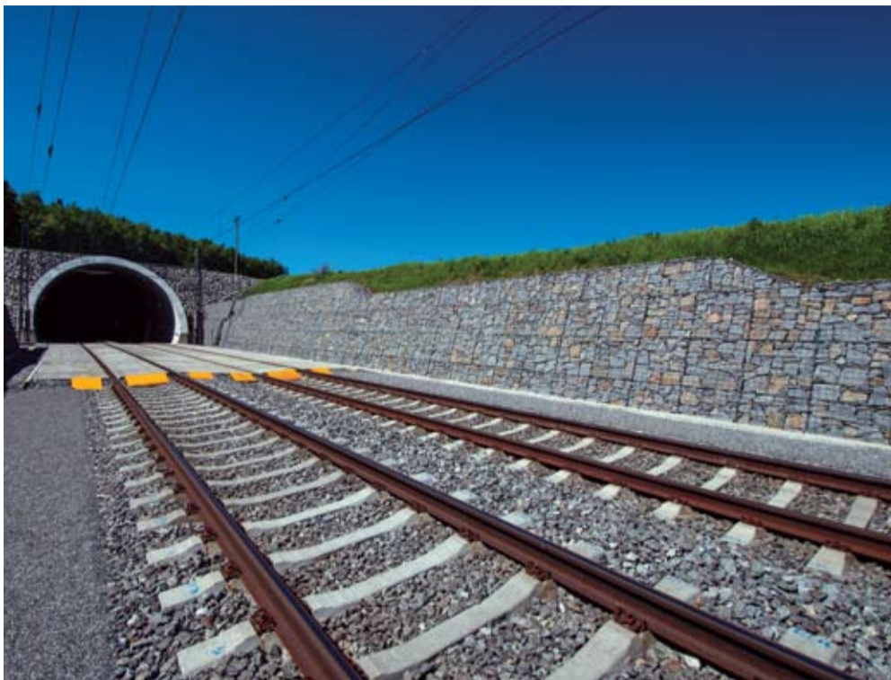
DOUKOLEJNÝ PROVOZ. Mezi Olbramovicemi a Tomicemi bylo položeno 5792 m kolejí. Foto: Pavel Richter
